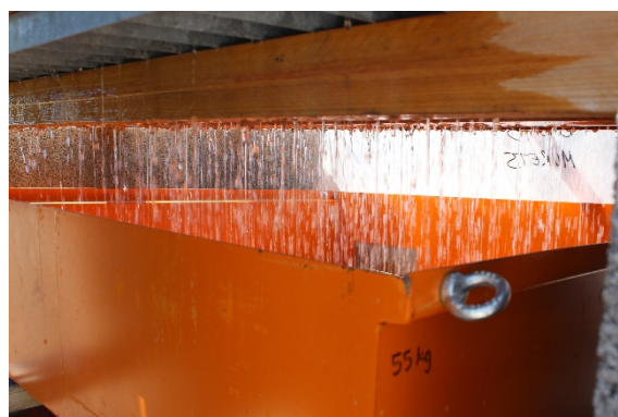
Figure 5 - Infiltration à travers le revêtement
