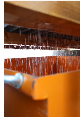
Figure 5 - Infiltration à travers le revêtement
