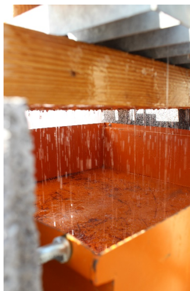
Figure 5 - Infiltration à travers le revêtement
