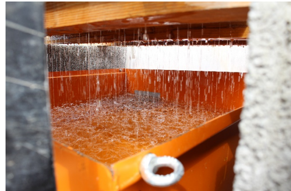
Figure 5 - Infiltration à travers le revêtement
