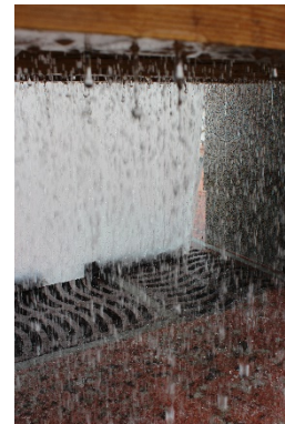
Figure 5 - Infiltration à travers le revêtement
