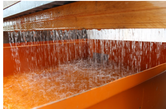
Figure 5 - Infiltration à travers le revêtement
